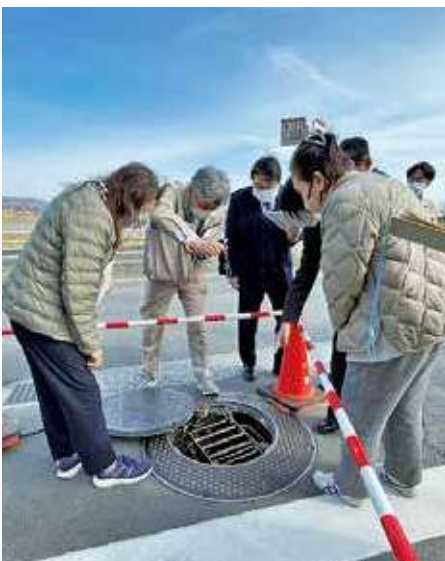
老朽化したマンホールポンプを 更新予定
