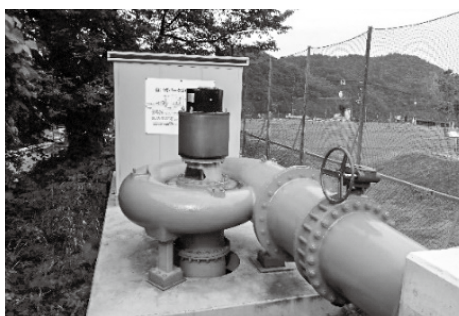
パークゴルフ場に設置された小水力発電施設
