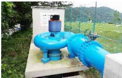
パークゴルフ場横の小水力発電所
