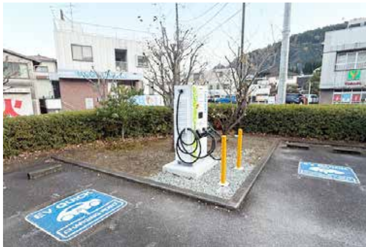
最大 30 分充電利用で軽自動車 50%程度充電が可能 役場正面駐車場（2 台分）
