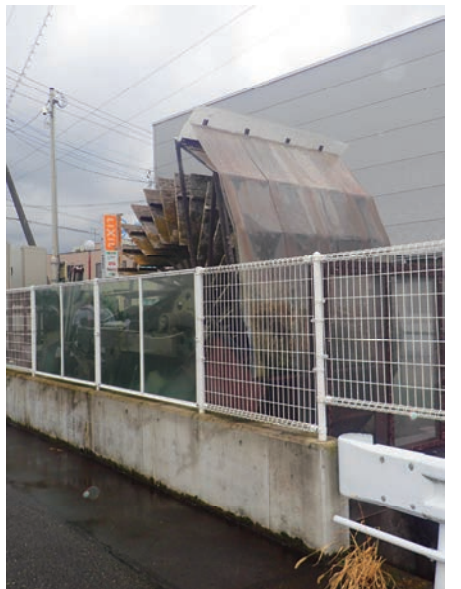
長泉町の小水力発電設備
