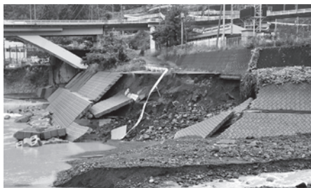
酒匂川の護岸が崩れる
