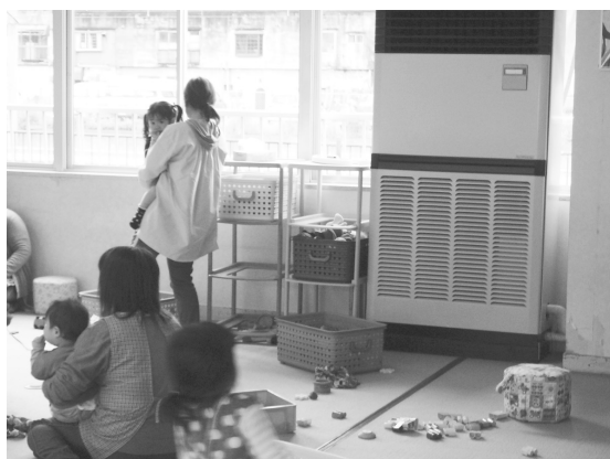
エアコンが設置されている保育園
