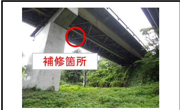
写真① 補修箇所
