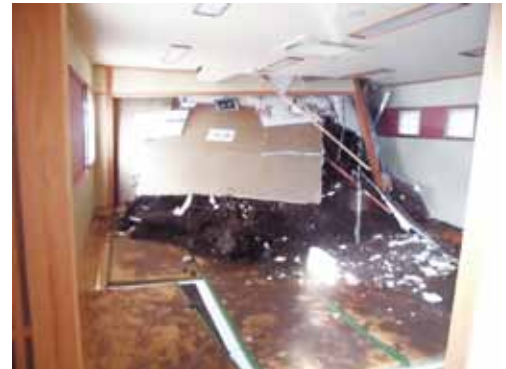
土砂の流入により見直しが必要な避難所
