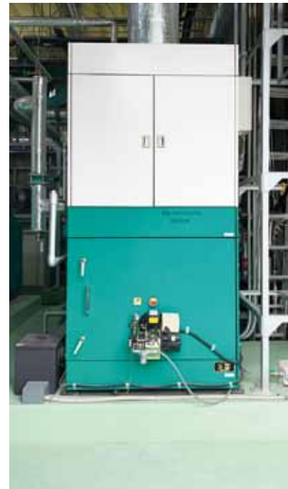
エネルギーの地産地消と経済の町内循環を可能にする木質バイオマスボイラー
