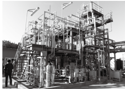
相分離系変換システム実証プラント
