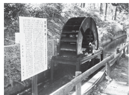
小水力発電設備
